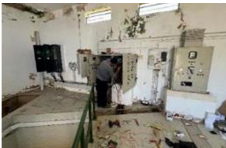
Figura 3. Exemplo de medida relativa ao reforço do Sistema de Abastecimento de Água em Alta da Águas do Algarve com a reabilitação de captações de água de origem subterrânea
