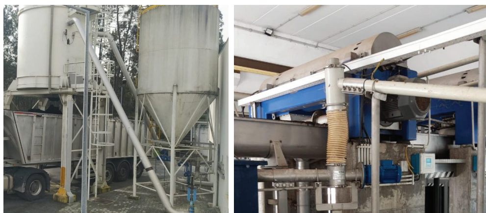
Figura 1. Silo de armazenamento de lamas, silo de armazenamento de óxido de cálcio e sistema de dosagem de óxido de cálcio
