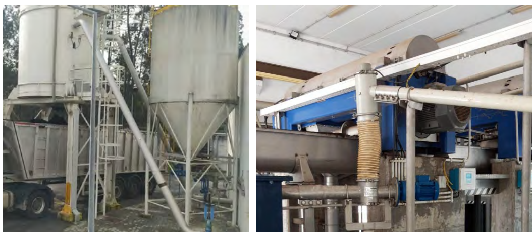
Figura 1. Silo de armazenamento de lamas, silo de armazenamento de óxido de cálcio e sistema de dosagem de óxido de cálcio
